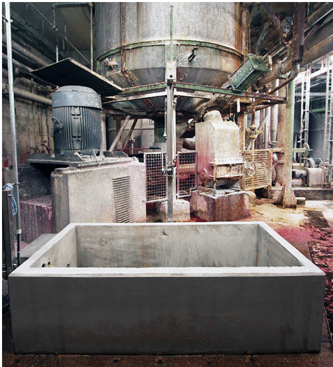
Papierwerke Lenk groundwater collector
